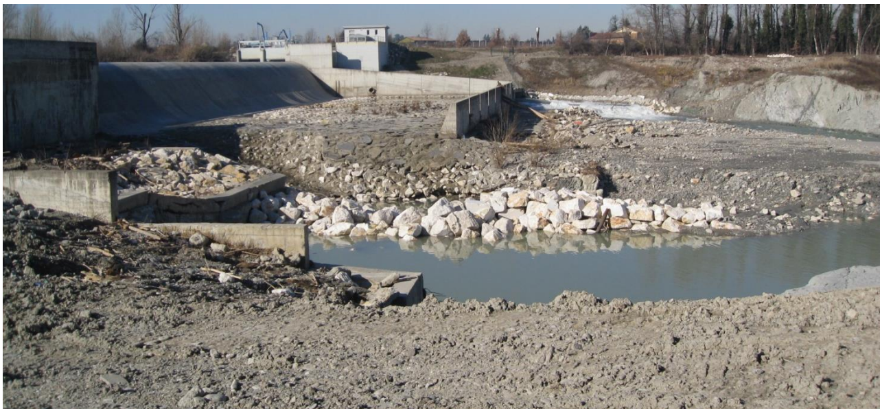
Figura 1 Vista dell’opera di dissipazione esistente composta da briglia e controbriglia con speroni. In condizione di piana ordinaria, l’opera devia la corrente verso la sponda destra provocando fenomeni erosivi consistenti sul fondo alveo (profondità 6/8 m), come è possibile constatare dall’immagine fotografica. Sullo sfondo è visibile l’Impianto idroelettrico.
